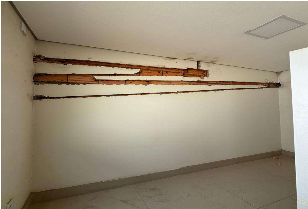
FOTO 9 - RASGO EM ALVENARIA PARA PASSAGEM DE FIAÇÃO ELÉTRICA E TUBULAÇÃO DE AR CONDICIONADO.
