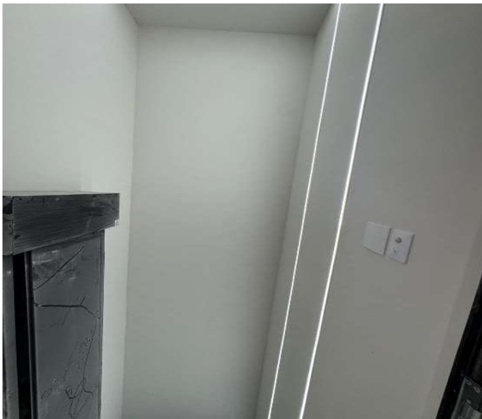
FOTO 37 - INSTALAÇÃO DE PERFIS DE LED E SENSORES NA PLATAFORMA DE ACESSIBILIDADE.
